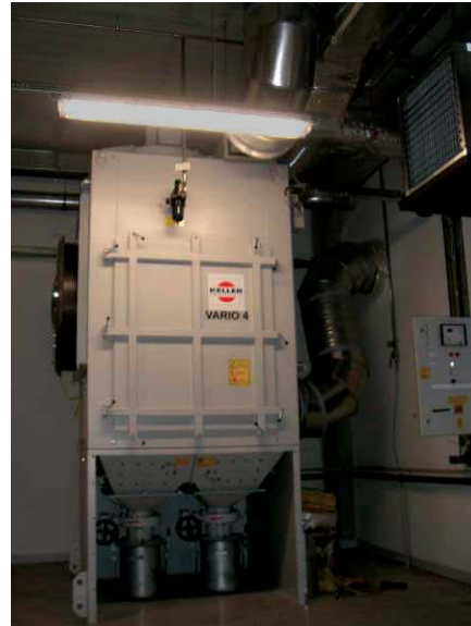
Filtre décentralisé avec valve de décharge d'explosion
