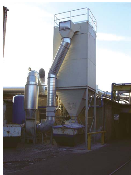
Centrale de filtration avec protections constructives contre l'explosion
