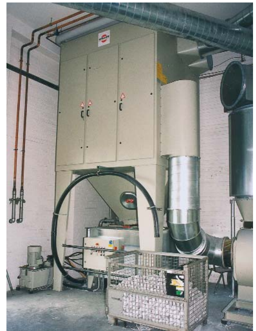
Installation de filtration avec briqueteuse de poussières
