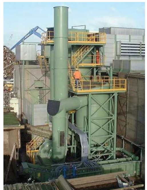
Dépoussiérage d'un broyeur de 3000 CV
