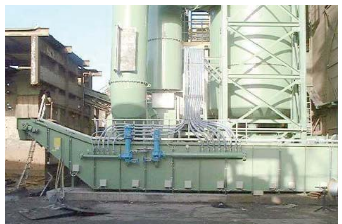
Système d'alimentation d'eau pour le dépolluage de broyeurs
