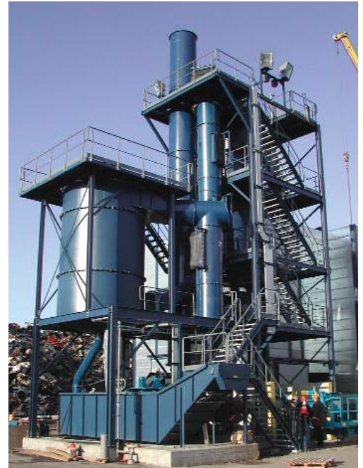
Dépoussiérage d'un broyeur de 1400 CV
